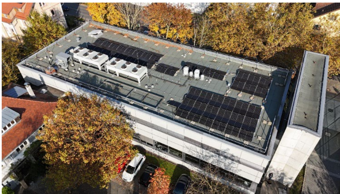
Abbildung 11: Teil der Photovoltaikanlage, installiert 2024 am Standort Zwingenberg in Deutschland
